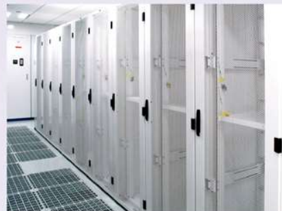
▲19インチサーバーラック
