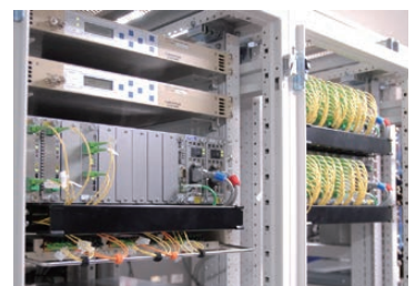
古河電工製 FTTH放送配信設備
