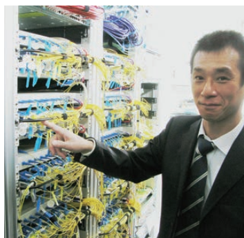
10Gアップグレード後も並行稼働している1G通信装置
