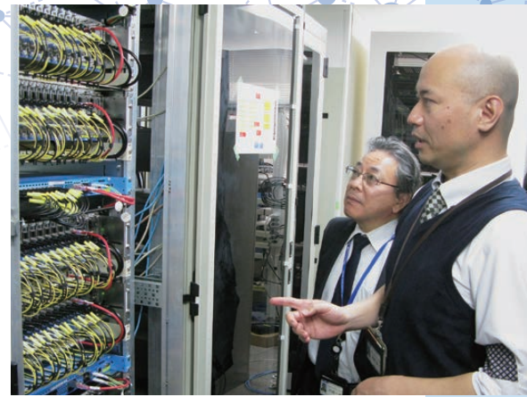
10ギガEPON通信設備
