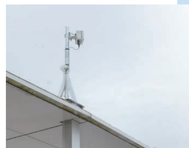
伊万里市駅ビル無線機
