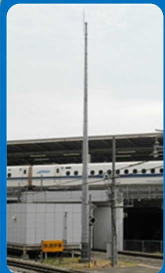
列車無線柱 (パンザーマスト)
