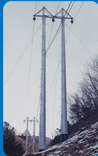
電力柱 (パンザーマスト)
