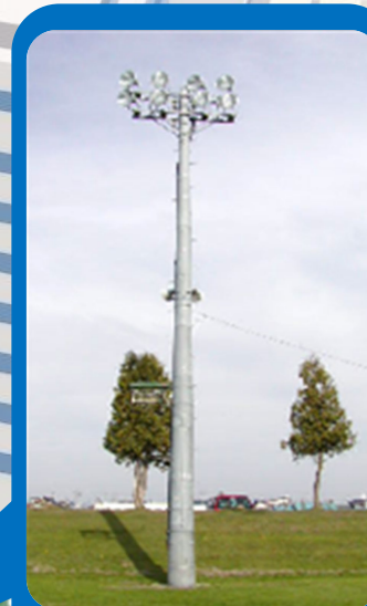
照明柱 (パンザーマスト)
